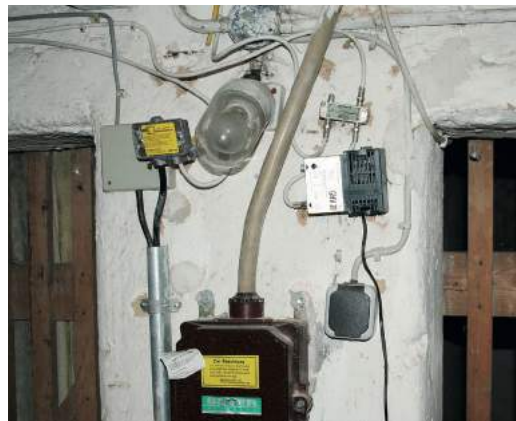
Beispiel für eine Laieninstallation
